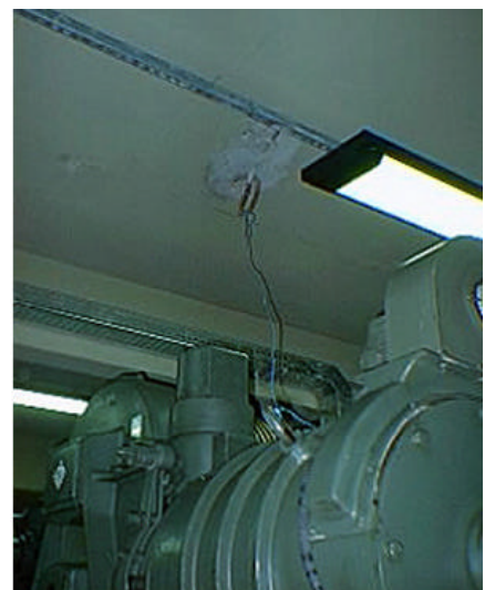
TIERRA DEL MOTOR EN EL GANCHO DE LA LOSA DE SALA DE MAQUINAS
